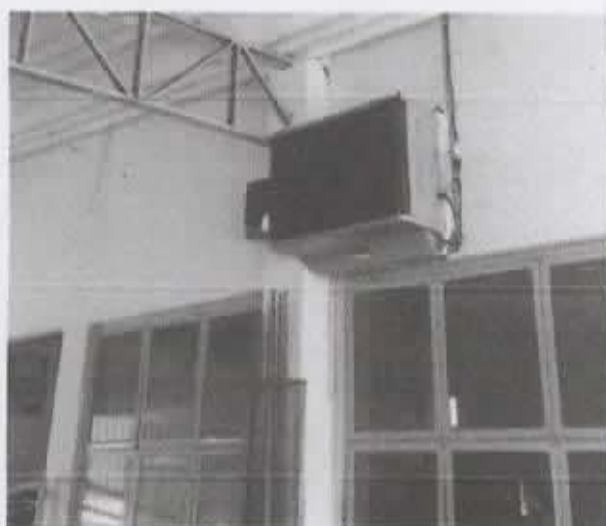
Climatizador – Sala de TV
