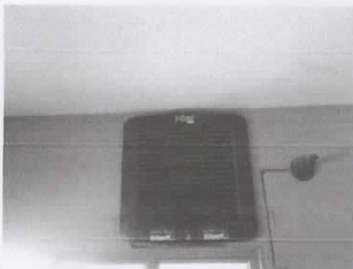
Climatizador – Sala de TV
